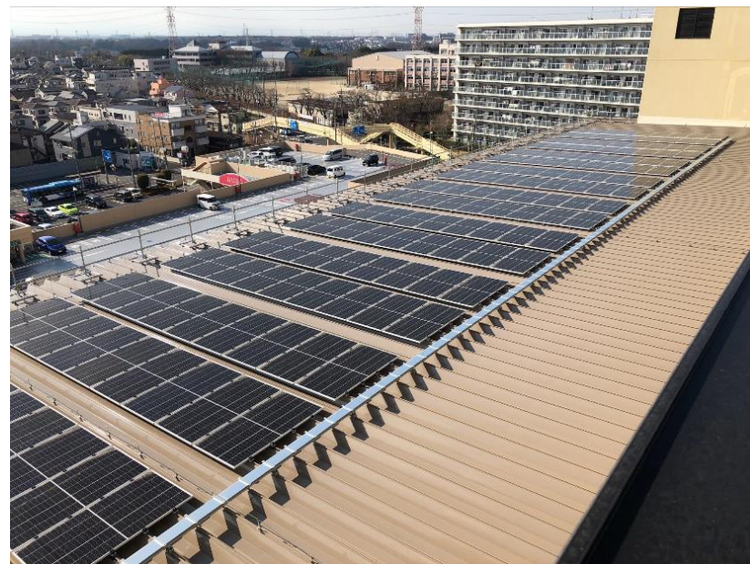
ねりま流通センターの太陽光発電パネル
